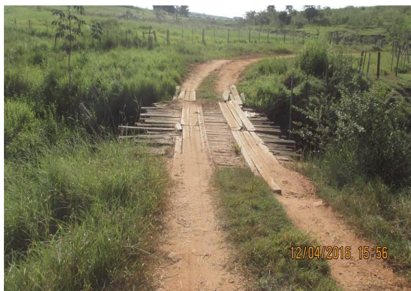
Figura 259 - Ponte de madeira com a plataforma em más condições com medidas de 10,20 x 4,40 x 3,60 metros.
