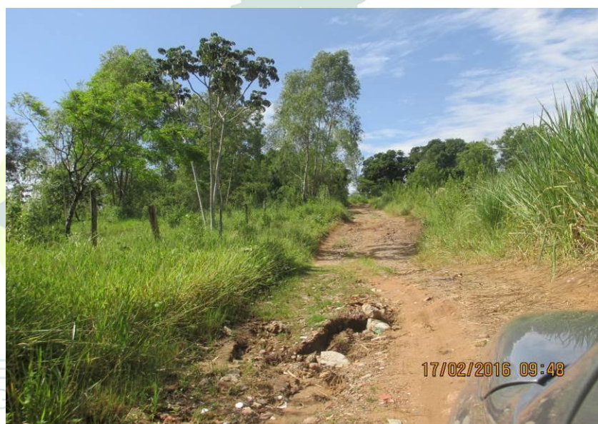
Figura 22 - Erosão no leito carroçável.
