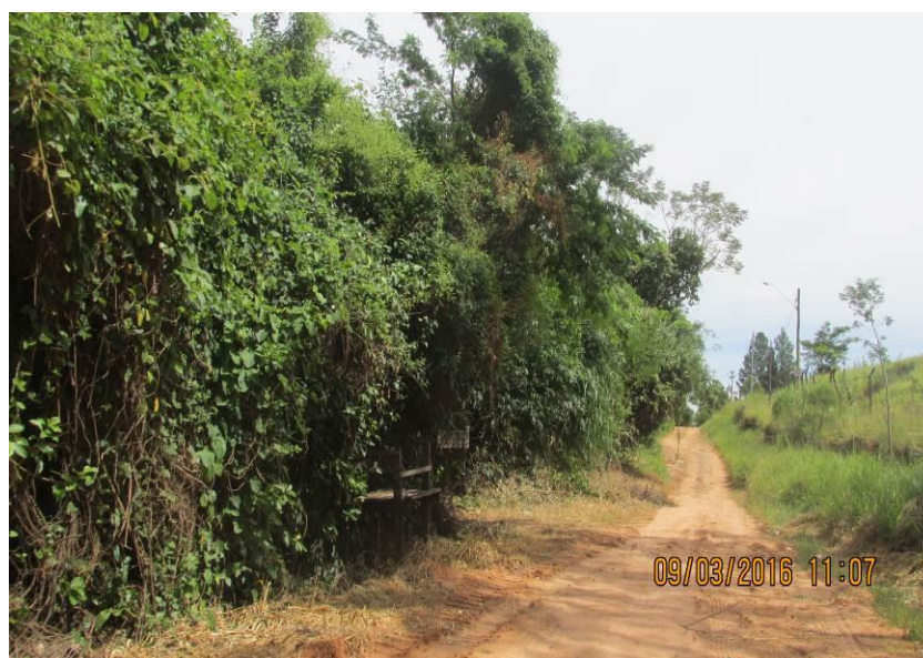
Figura 351 - Ausência de saída d'água.
