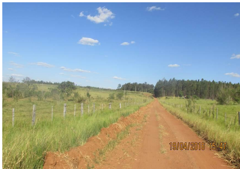
Figura 122 - Ausência de saída d'água.
