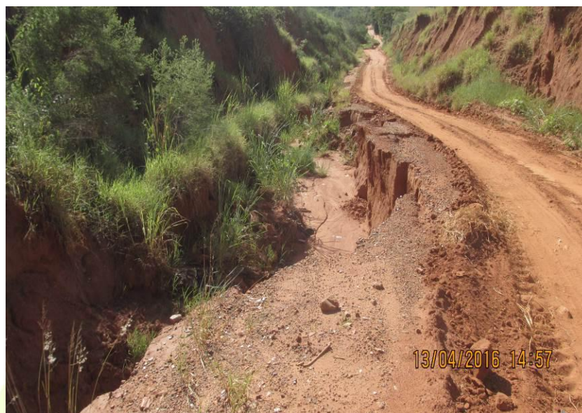
Figura 247 - Voçoroca invadindo o leito carroçável.
