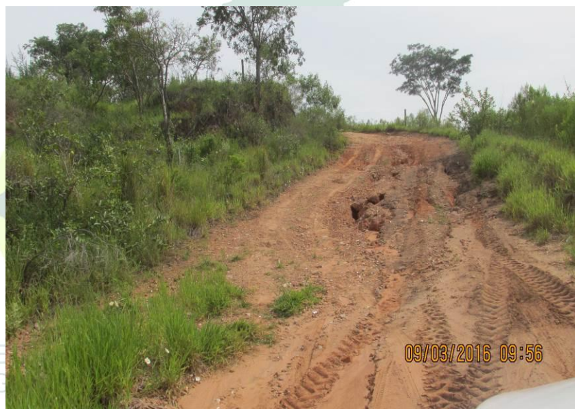
Figura 323 - Processo erosivo no leito carroçável.
