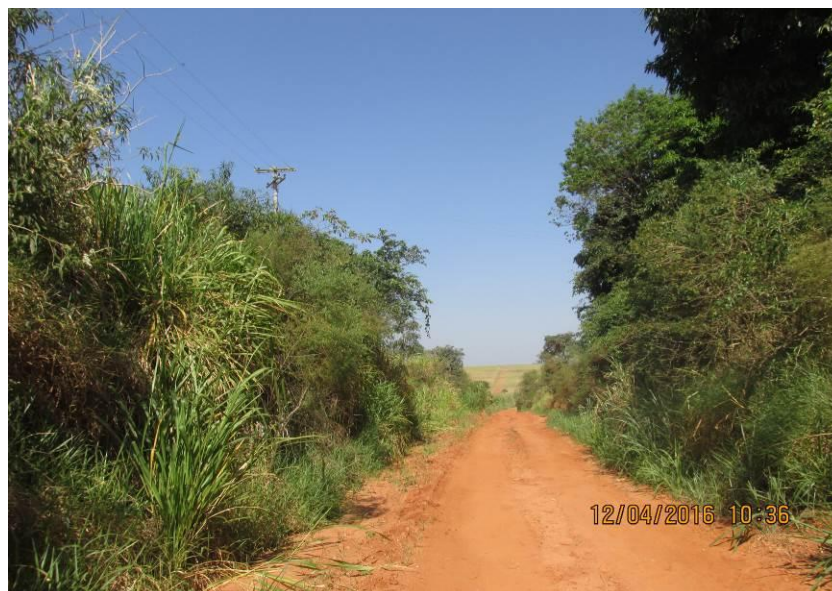
Figura 116 - Plataforma não conformada.
