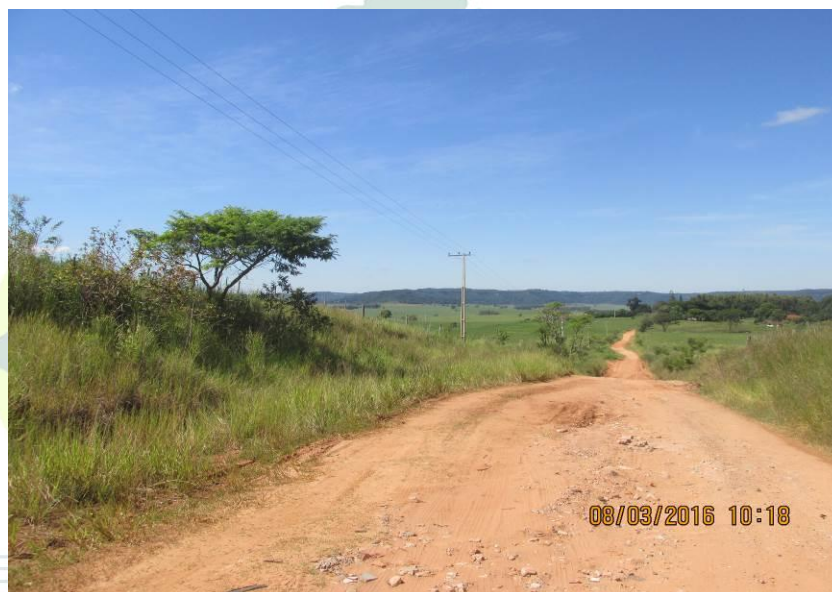
Figura 333 - Ausência de saída d'água.
