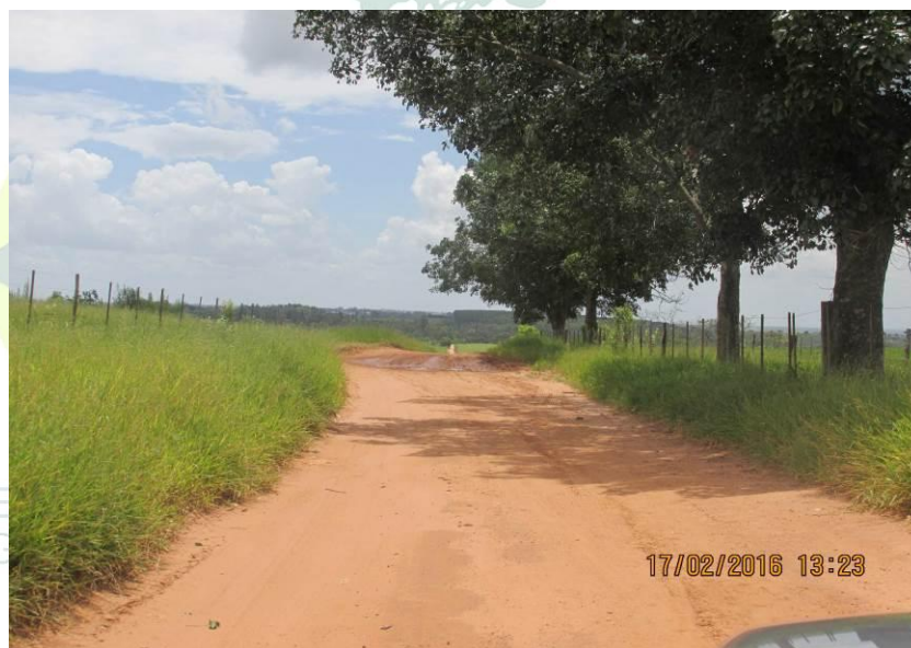
Figura 33 - Ausência de revestimento.
