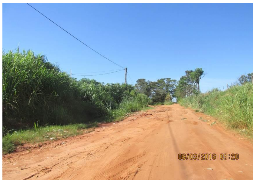
Figura 334 - Plataforma não conformada.
