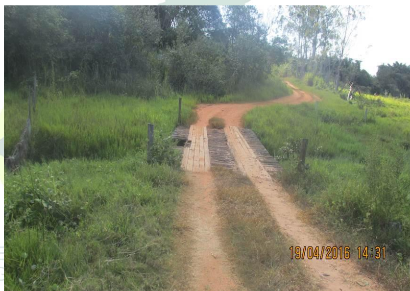
Figura 132 - Ponte de madeira com a plataforma danificada de 9,80 x 4,10 x 2,90 metros.
