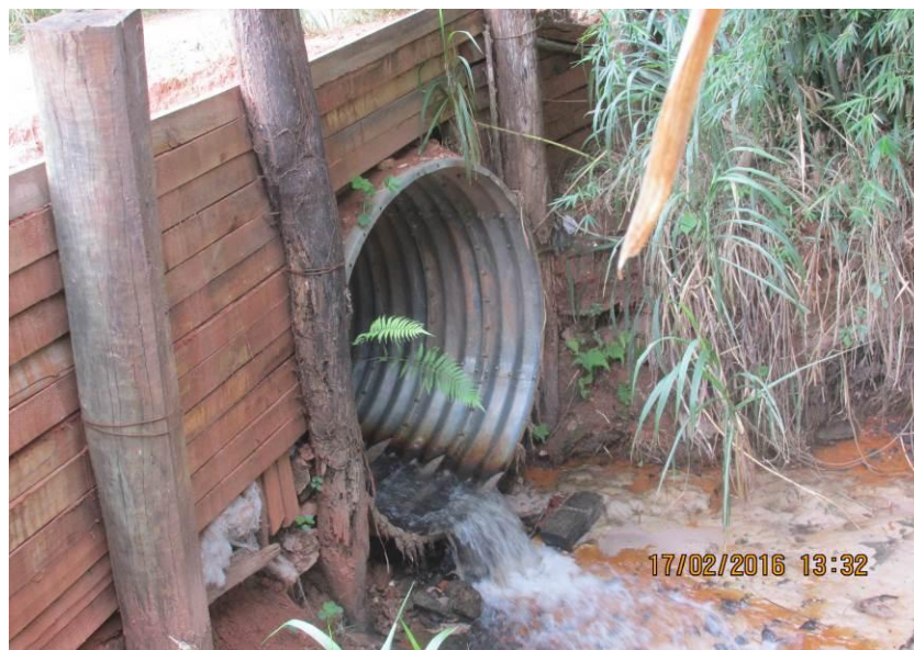
Figura 36 - Tubulação de armco de 1500 mm.
