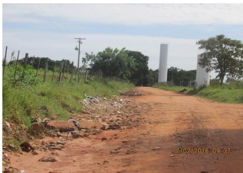
Figura 20 - Plataforma não conformada.
