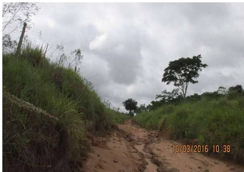
Figura 267 - Processo erosivo no leito carroçável.
