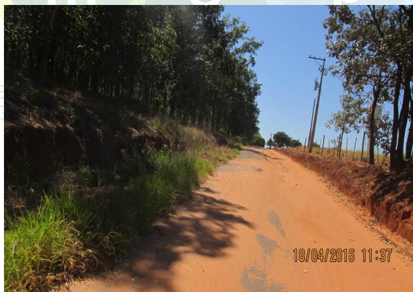
Figura 170 - Ausência de sistema de drenagem.
