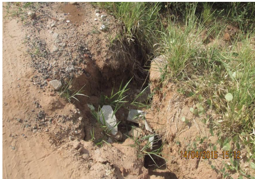
Figura 222 - Processo erosivo na lateral da estrada.
