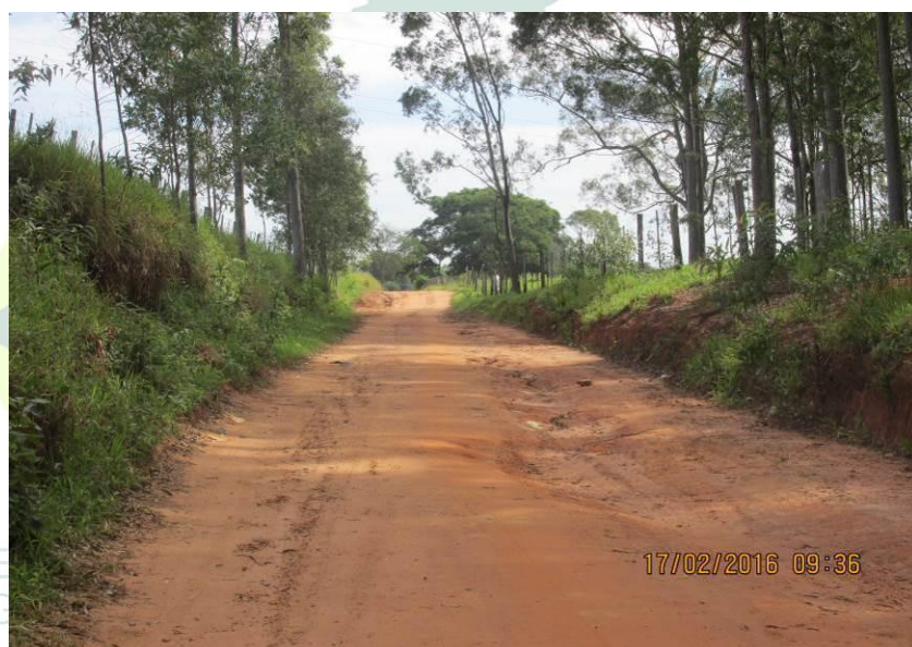
Figura 19 - Trecho sem saída d'água.
