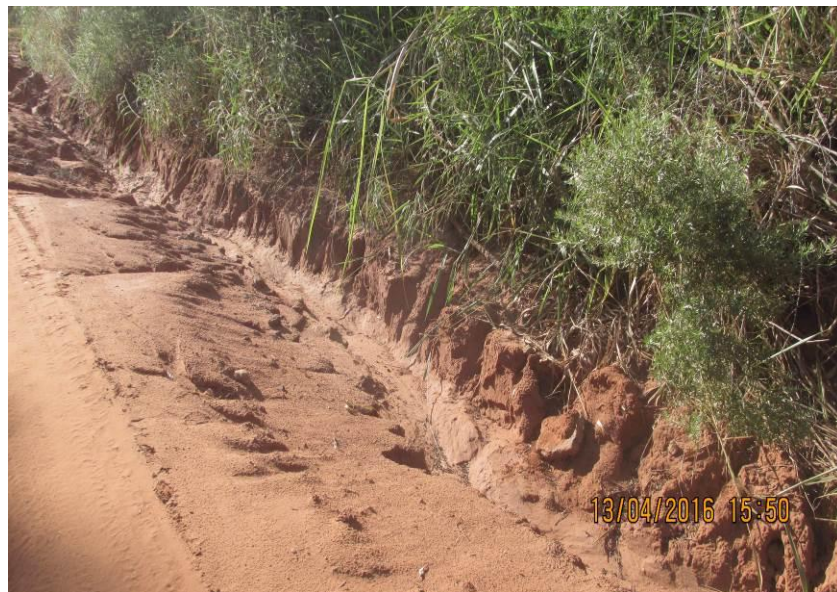
Figura 237 - Processo erosivo na lateral da estrada.
