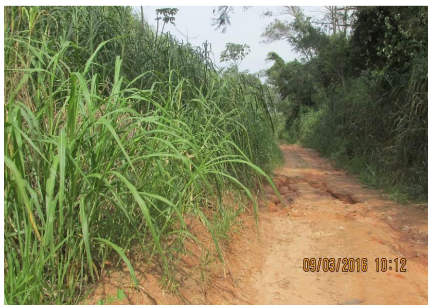
Figura 329 - Processo erosivo no leito carroçável.
