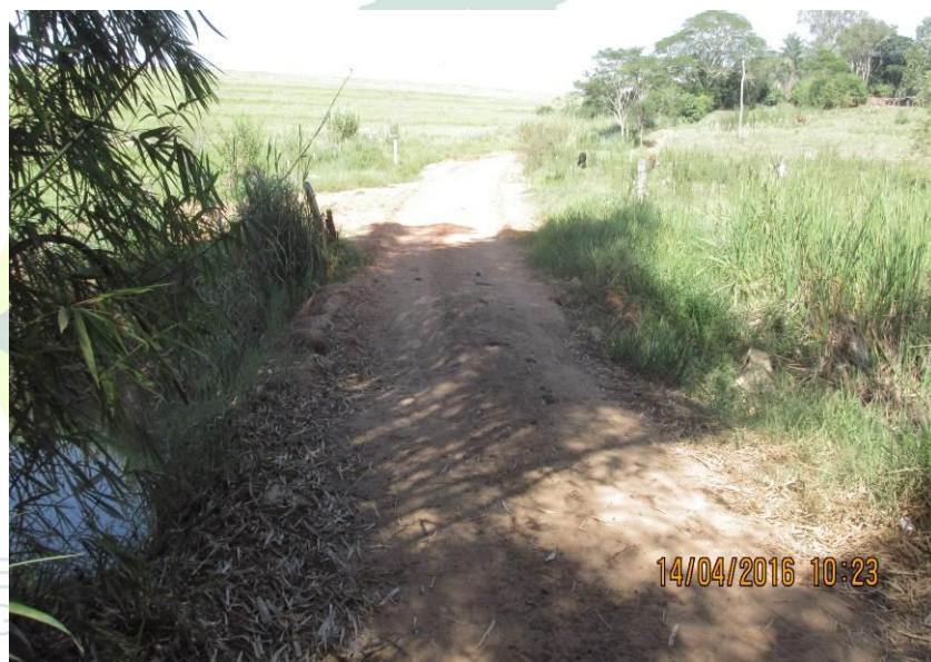
Figura 205 - Ponte de concreto destruída.
