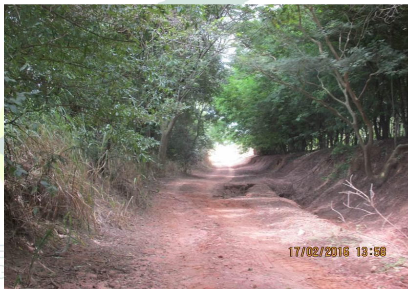
Figura 38 - Erosão na lateral da estrada.
