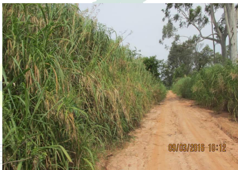
Figura 330 - Plataforma não conformada.
