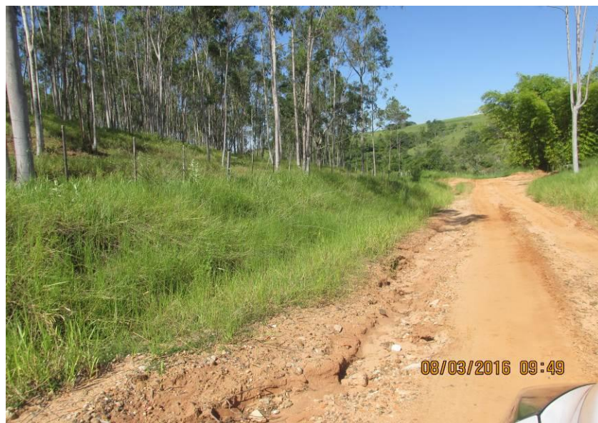
Figura 339 - Processo erosivo na lateral da estrada.
