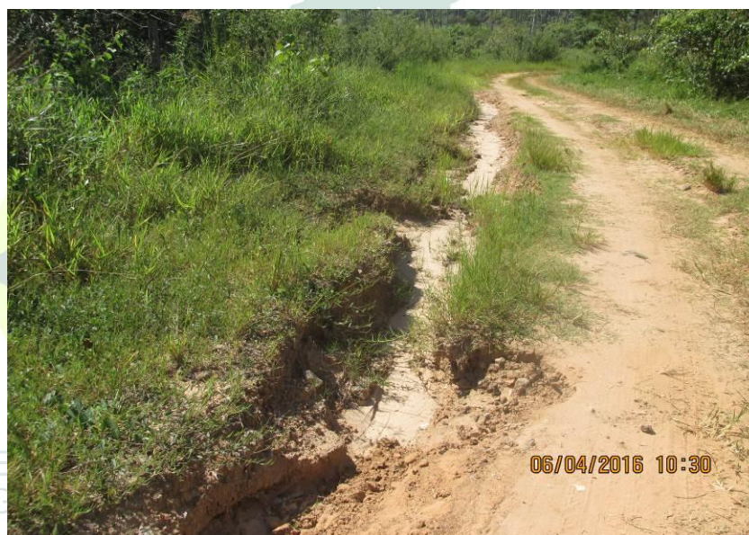
Figura 279 - Processo erosivo na lateral da estrada.
