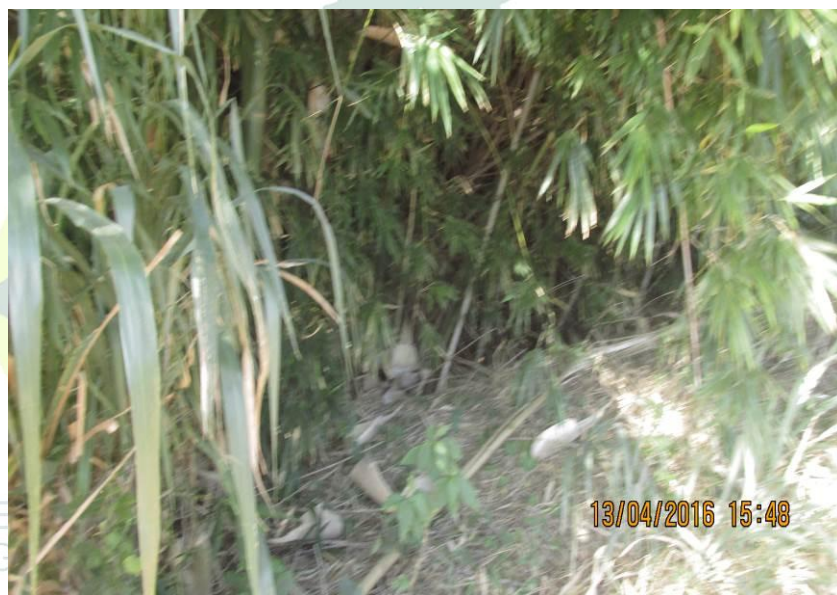
Figura 242 - Tubo armco de 3000 mm.
