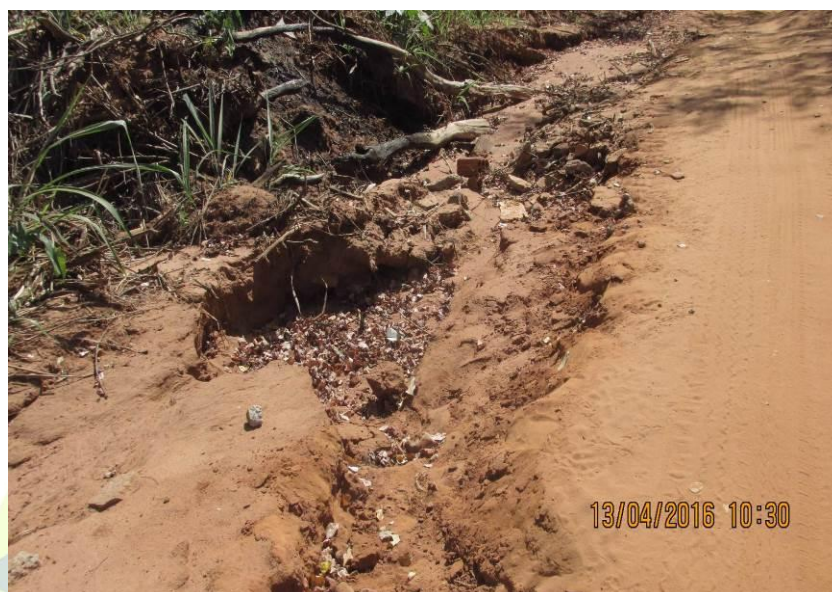
Figura 57 - Erosão na lateral da estrada.
