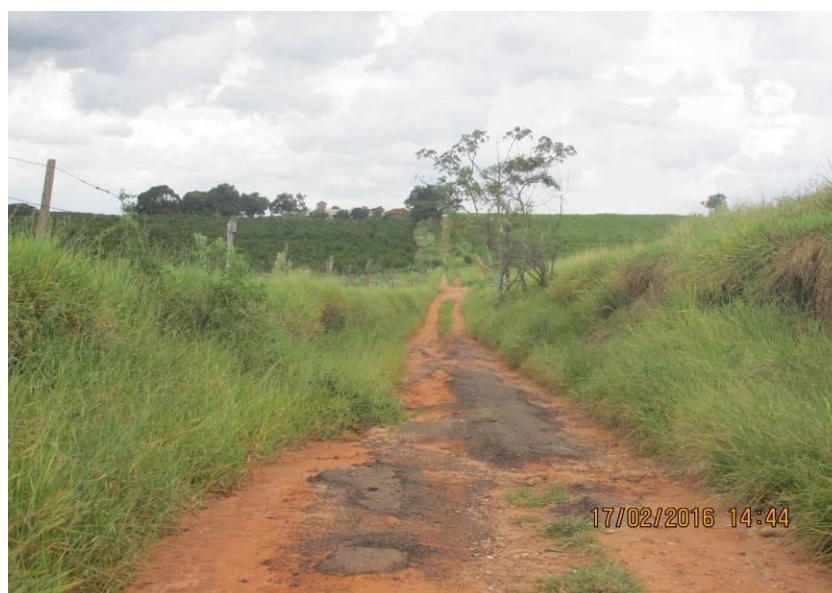
Figura 41 - Trecho revestido com sobras asfálticas.
