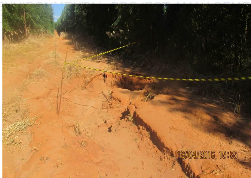
Figura 128 - Processo erosivo no leito carroçável.
