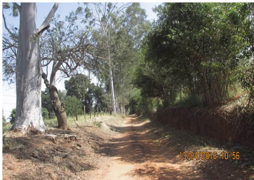
Figura 255 - Ausência de saída d'água.
