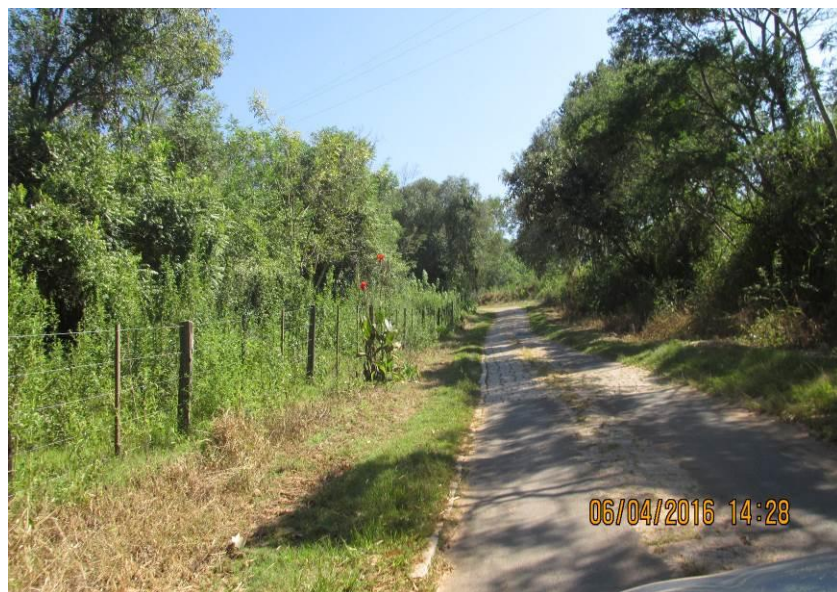
Figura 289 - Trecho revestido com paralelepípedo.
