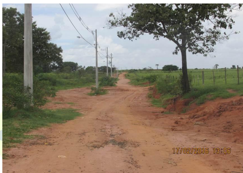
Figura 31 - Plataforma não conformada.
