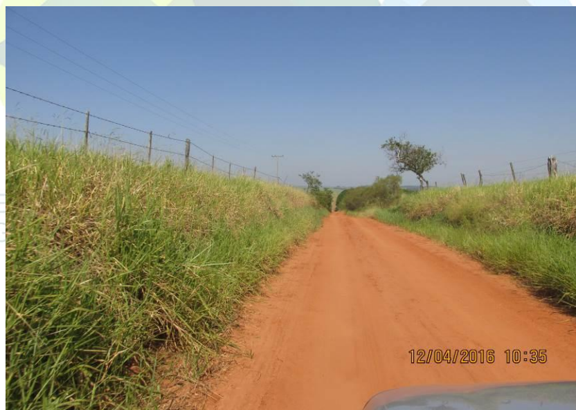
Figura 117 - Ausência de saída d'água.
