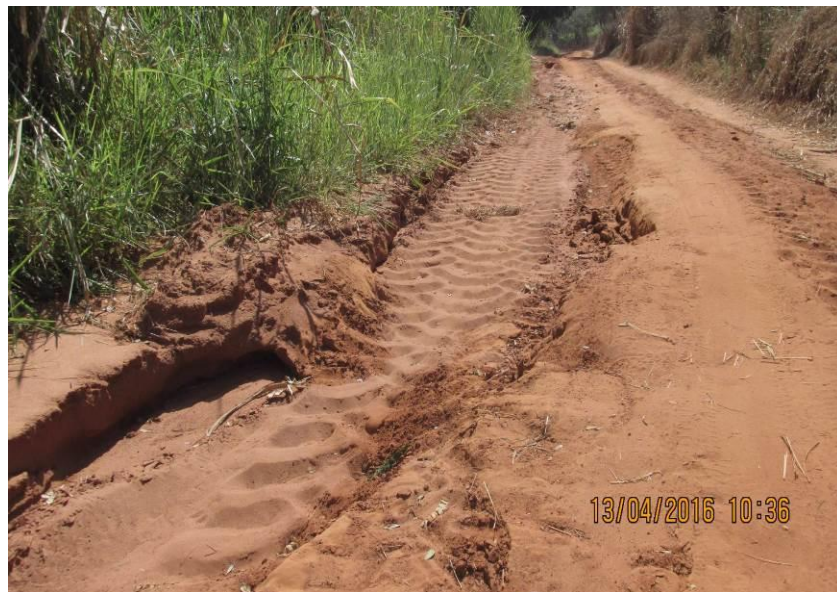
Figura 59 - Processo erosivo na lateral da estrada.
