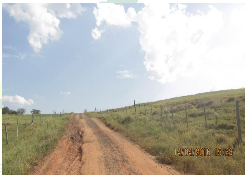
Figura 210 - Processo erosivo no leito carroçável.
