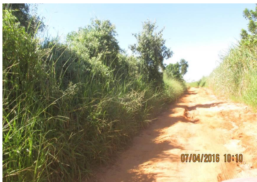
Figura 305 - Processo erosivo no leito carroçável.
