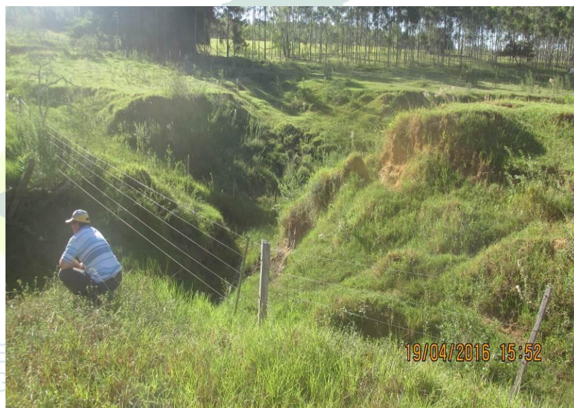
Figura 123 - Voçoroca na lateral da estrada.
