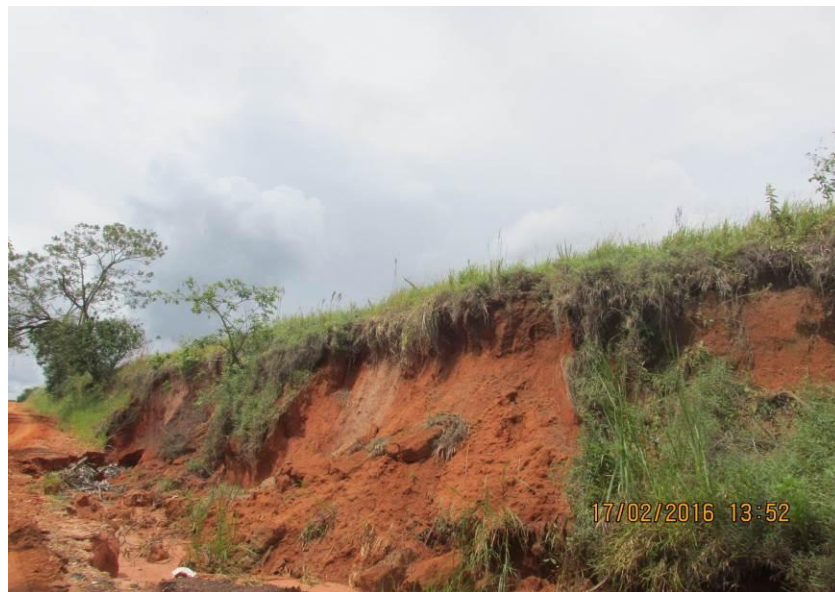
Figura 37 - Desmoronamento do barranco.
