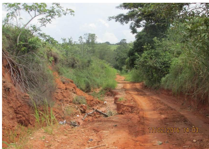
Figura 39 - Processo erosivo na lateral da estrada.
