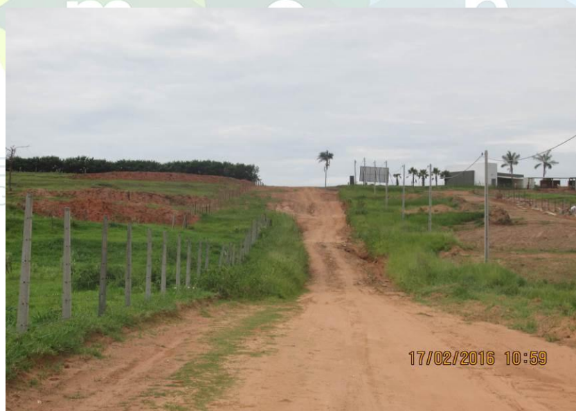
Figura 30 - Ausência de saída d'água.
