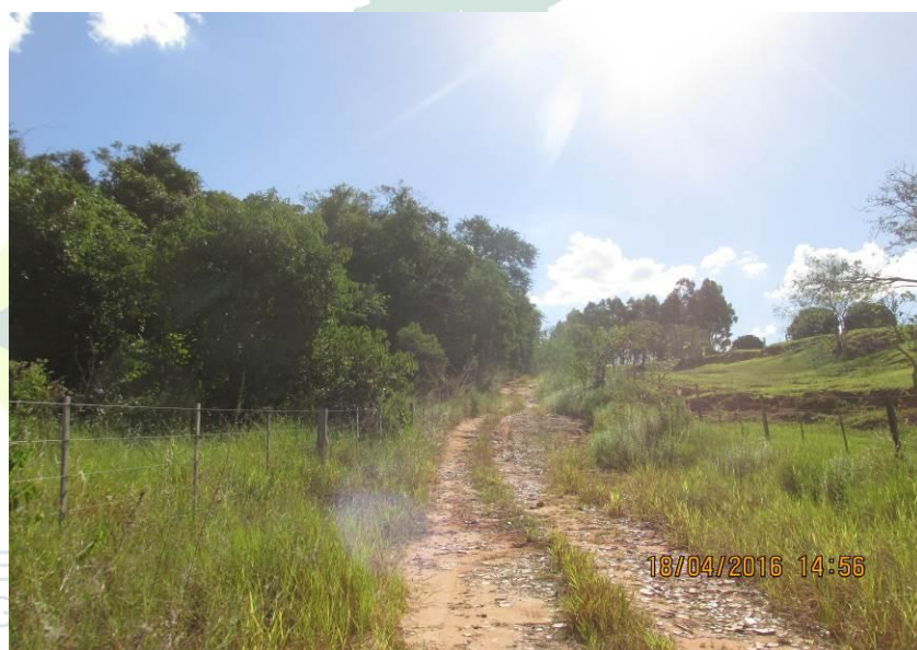
Figura 164 - Revestimento com entulho de construção civil.
