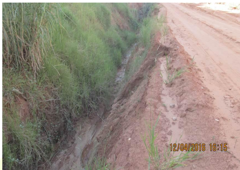
Figura 257 - Processo erosivo na lateral da estrada.
