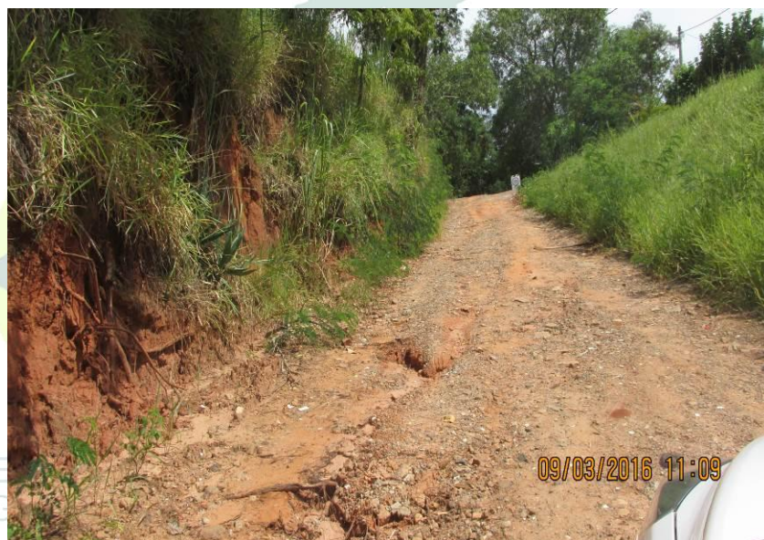
Figura 350 - Processo erosivo no leito carroçável.
