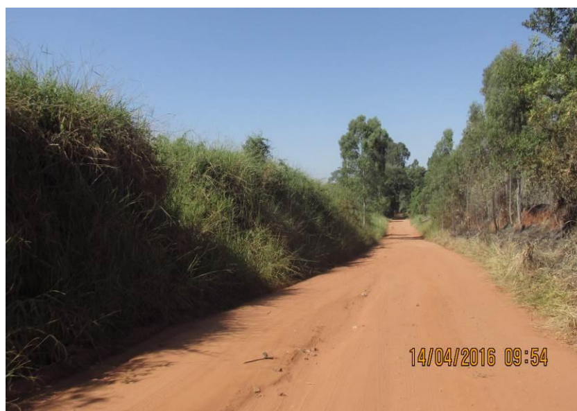
Figura 231 - Processo erosivo no leito carroçável.
