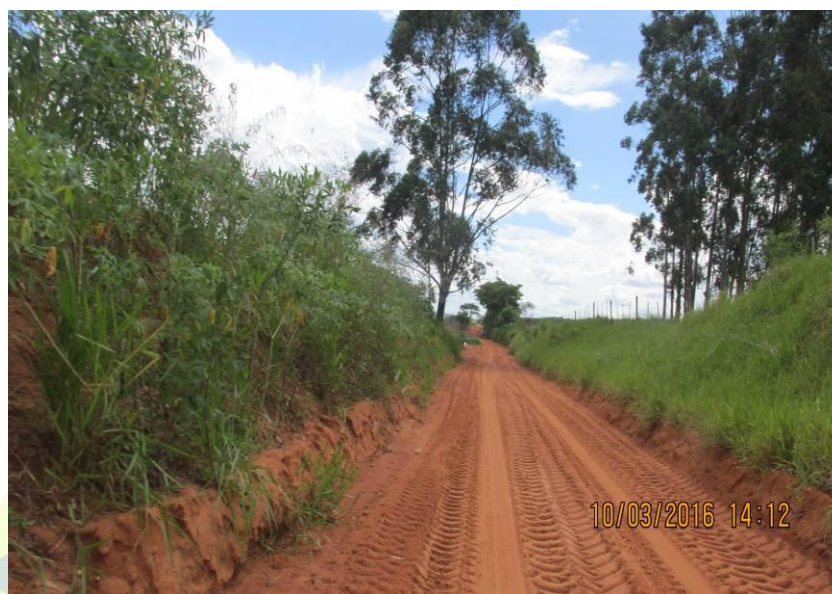
Figura 319 - Ausência de saída d'água e areião.
