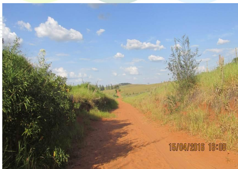
Figura 186 - Ausência de saída d'água.
