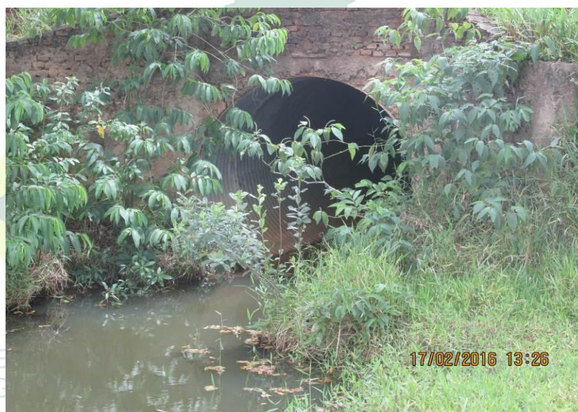
Figura 35 - Tubulação de armco de 2500 mm.
