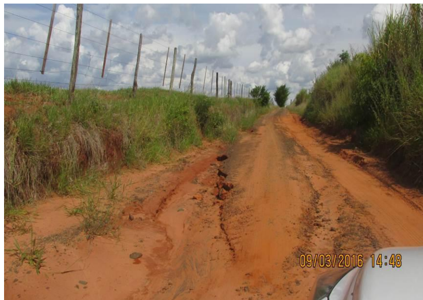
Figura 331 - Processo erosivo na lateral da estrada.
