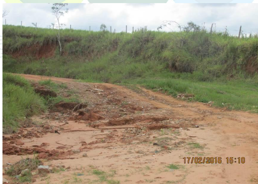
Figura 44 - Erosão na lateral da estrada.
