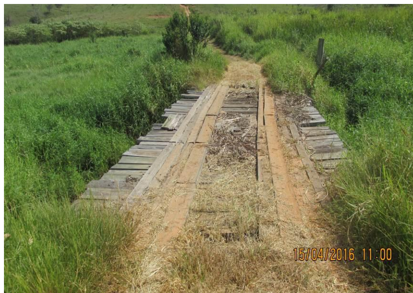
Figura 193 - Ponte de madeira em más condições medindo 11,60 x 4,60 x 2,20 metros.
