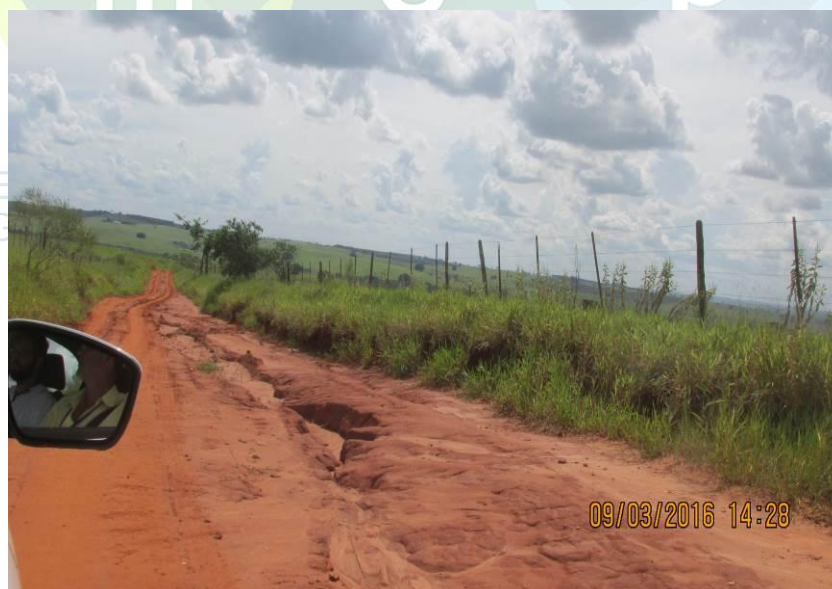
Figura 314 - Processo erosivo na lateral da estrada.
