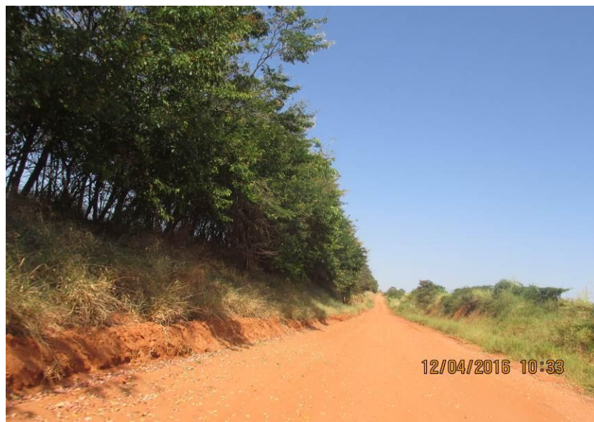
Figura 63 - Plataforma não conformada e barranco.
