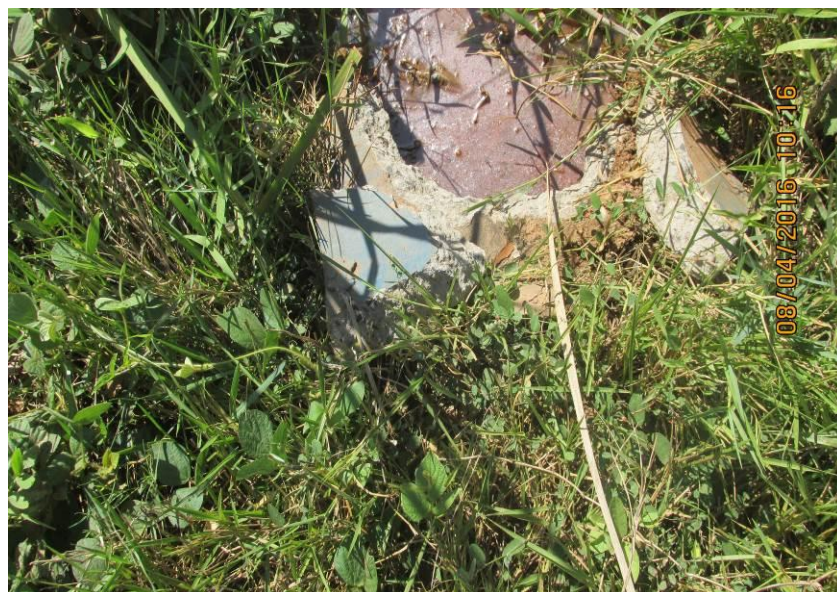
Figura 108 - tubulação de concreto danificada de 600 mm.
