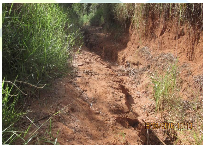
Figura 184 - Processo erosivo no leito carroçável.
