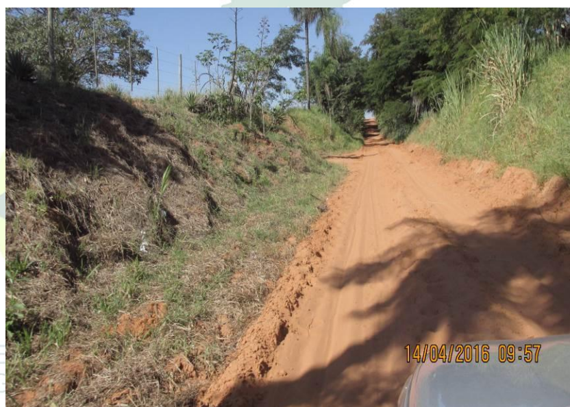
Figuras 232 e 233 – Processo erosivo no leito carroçável e areão.
