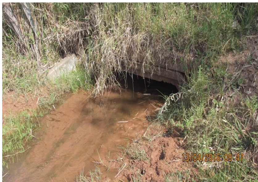
Figura 239 - Aduela de concreto assoreada de 1,5 x 1 m.
