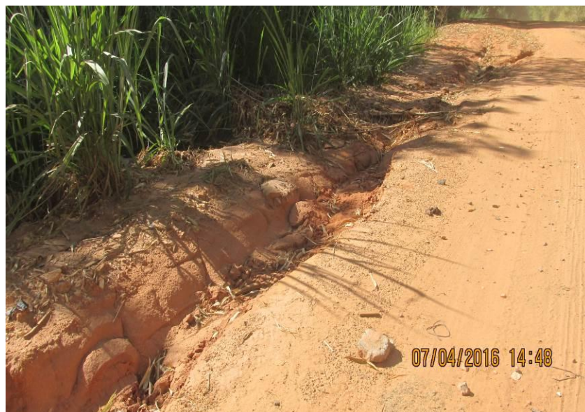
Figura 100 - Processo erosivo na lateral da estrada.
