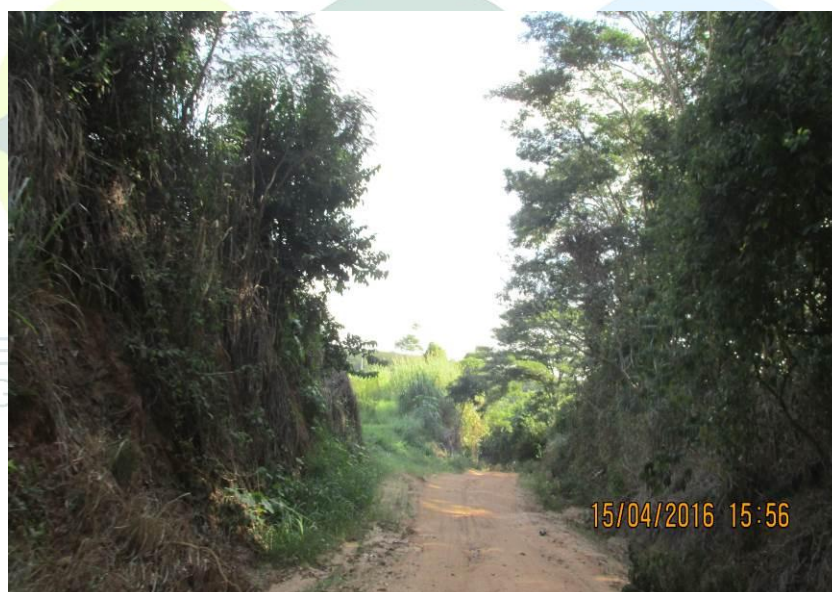
Figura 190 - Ausência de saída d'água.
